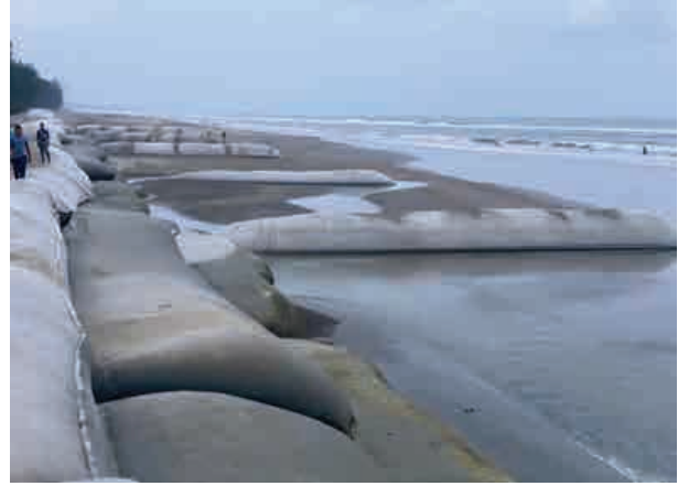
Figure 2: সী-বীচ, কক্সবাজার, Wave Breaker/Silt trap
